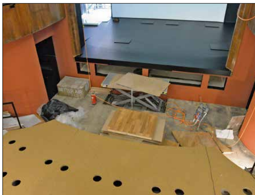
Die verschiebbare Bestuhlung des Parketts ermöglicht die Erschliessung einer grossen Stehfläche. In der Bildmitte ausserdem die neue Hebebühne. Bilder: David Kocher
